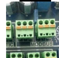
Repère 6 Bornier Modbus
